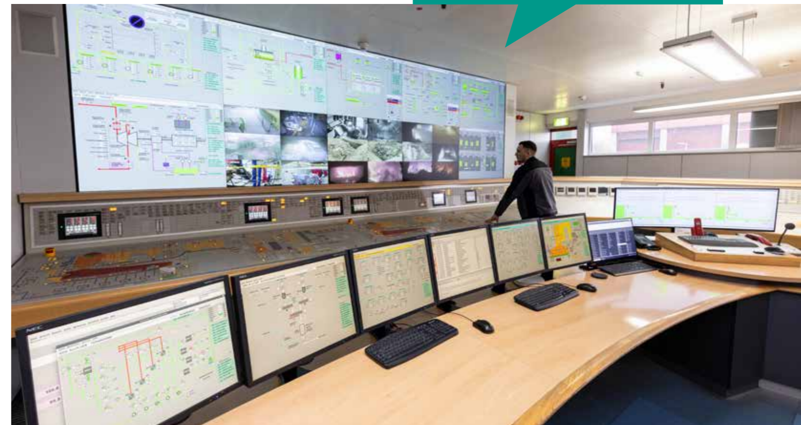
Abbildung: Schaltwarte des MHKW's
