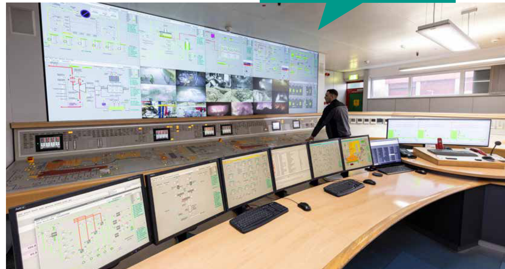
Abbildung: Schaltwarte des MHKWs
